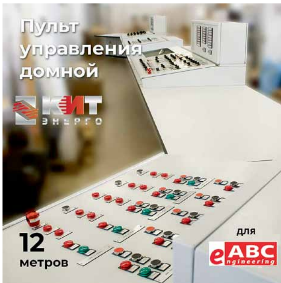
Рис. 1. Пульт управления доменной печью Новоліпецкого металлургического комбината
