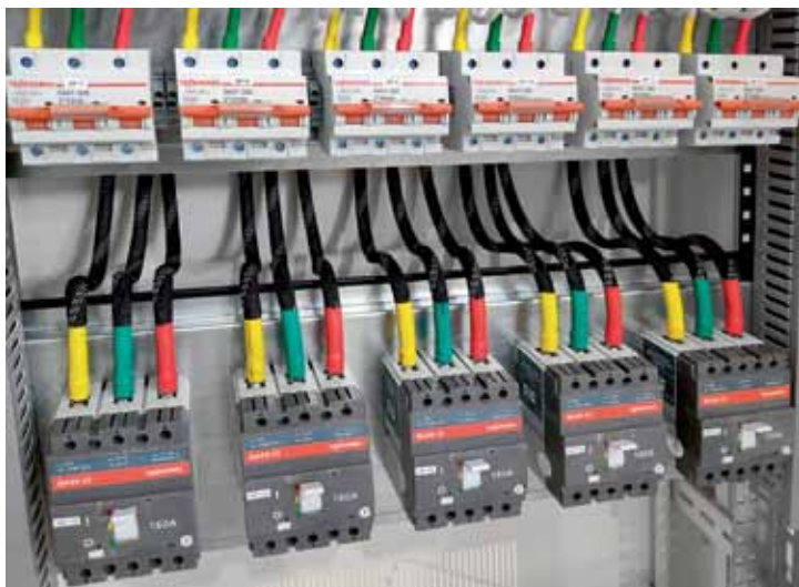
Рис. 8. Для защиты изоляции проводов от механических повреждений применяется кабельная оплетка. Также она повышает эстетичность решения
