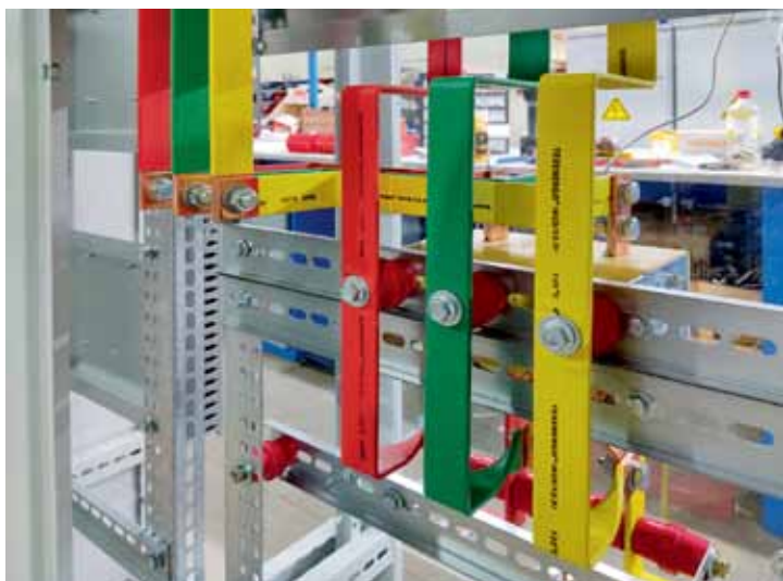
Рис. 7. Для производства шкафов используются термоусадочные трубки из негорючих материалов высокого качества, которые обладают изоляционными, защитными и антикоррозийными свойствами
