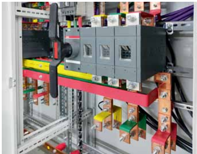
Рис. 1. Для производства шкафов используются болты класса прочности только 8.8, хотя по ГОСТ допустимо 5.8. Также в целях повышения надежности электрического соединения применяются тарельчатые шайбы, а не гровер
