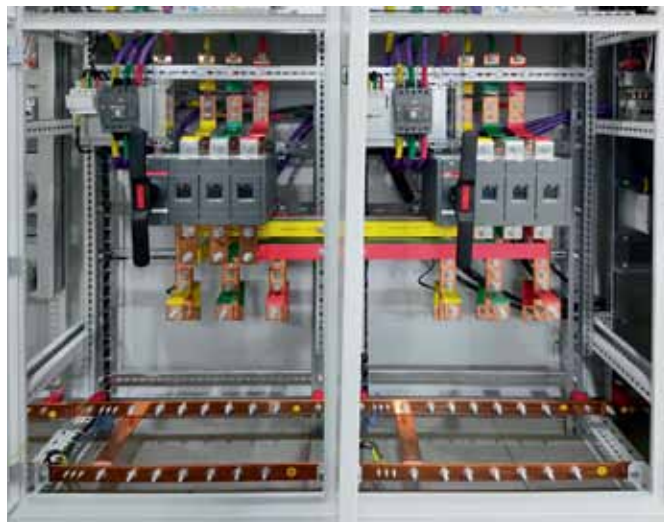
Рис. 2. Соединение перекидных рубильников между собой на вводных панелях выполняется медными заизолированными шинами. Разное цветовое исполнение изоляции позволяет специалисту быстрее ориентироваться в электрической схеме щита, а также повышает безопасность работы
