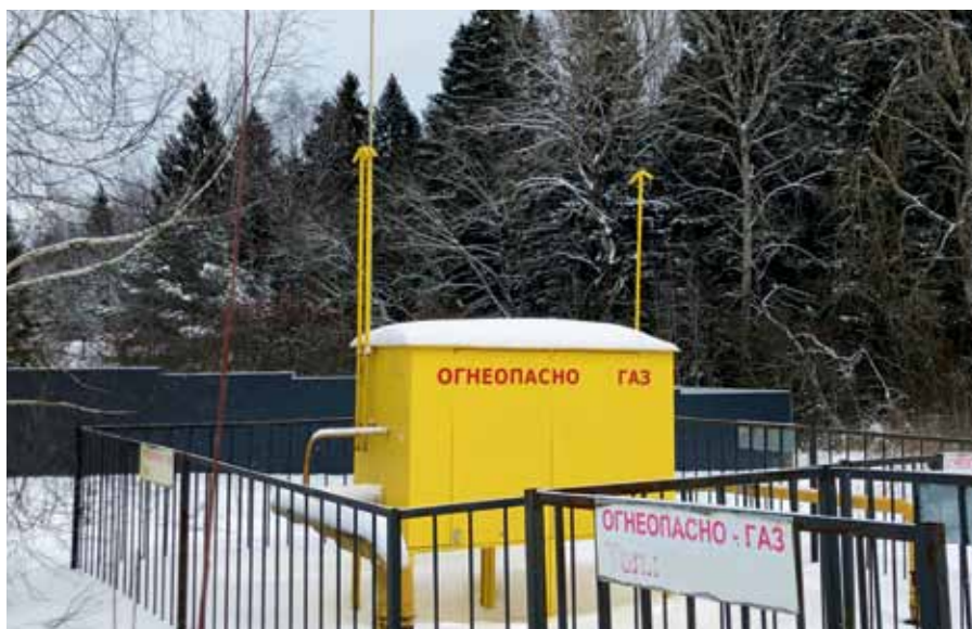
Рис. 7. Газорегуляторный пункт ГРП
