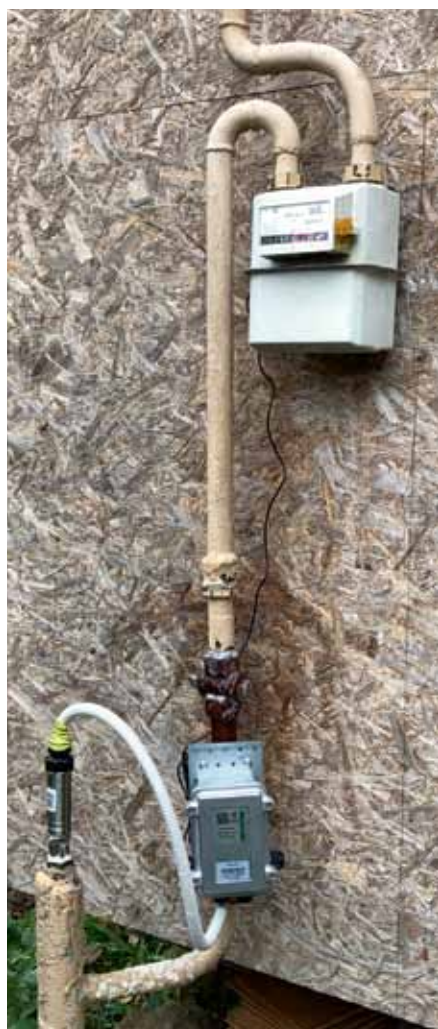
Рис. 5. Узел контроля PROMODEM на тупике газораспределения
