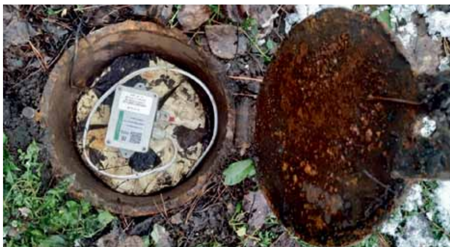
Рис. 13. Выносной узел контроля затопления тепловой камеры на базе логгера PROMODEM
