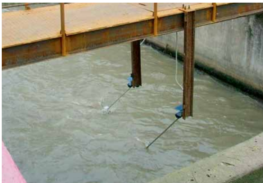
Рис. 2. Расходомер-счетчик безнапорных потоков «СТРИМ», установленный на объекте
