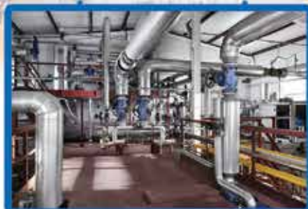
МОДЕРНИЗАЦИЯ И ПЕРЕОСНАЩЕНИЕ КОТЕЛЬНЫХ
