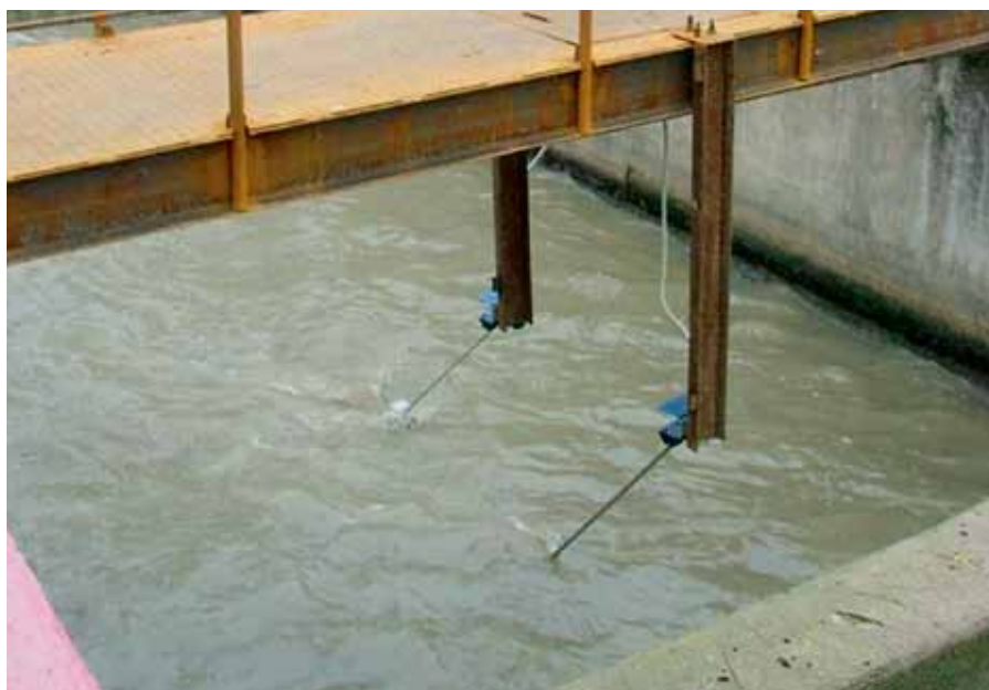
Рис. 2. Расходомер-счетчик безнапорных потоков «СТРИМ», установленный на объекте
