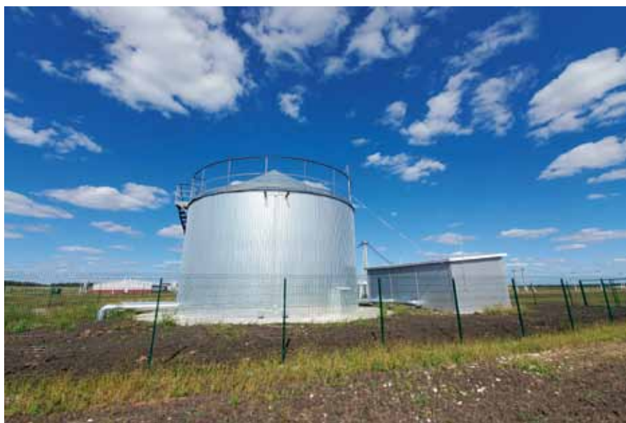
Рис. 4. Водозаборный накопительный резервуар и технический ангар
