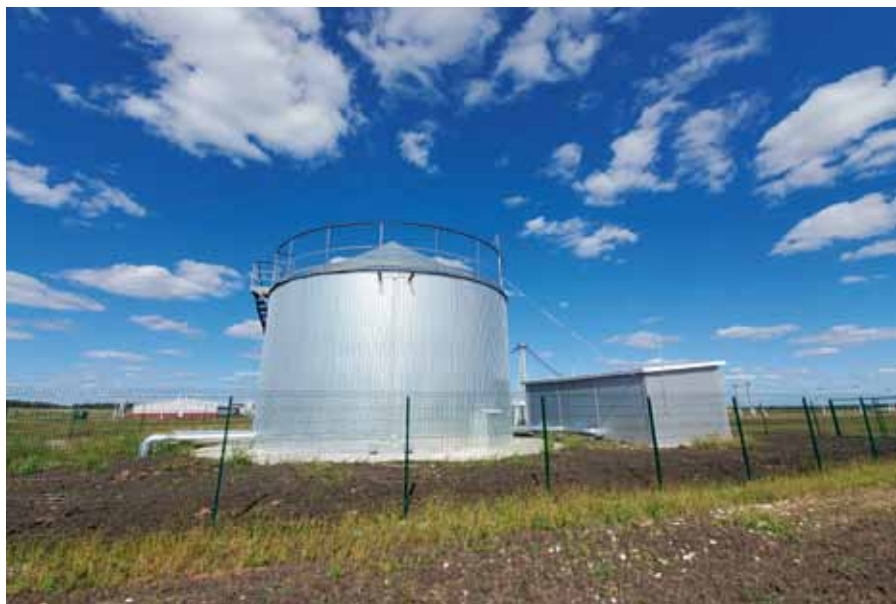
Рис. 4. Водозаборный накопительный резервуар и технический ангар
