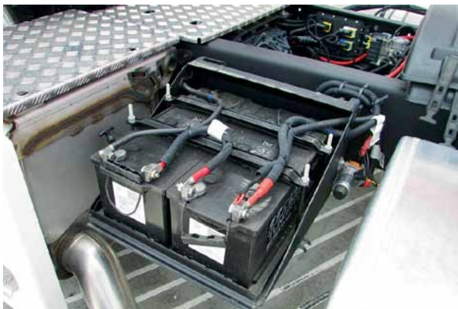
Рис. 3. Две АКБ, соединенные последовательно, на большегрузном транспорте
