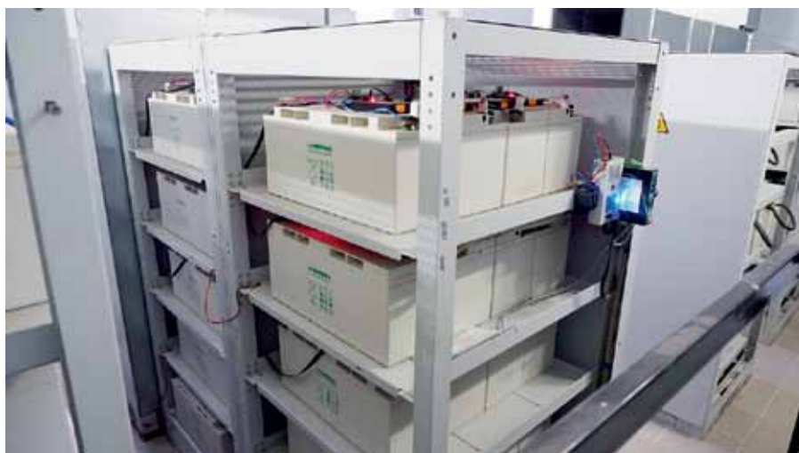
Рис. 9. Система балансировки на ИБП 200 кВА с сорока аккумуляторами
