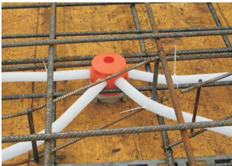
Рис. 3. Электромонтажная система KOPOS перед заливкой бетоном
