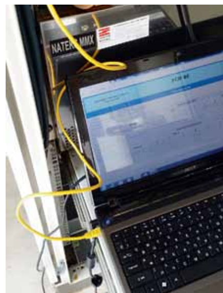
Рис. 3. Мониторинг состояния аккумуляторных батарей дизель-генераторной установки через веб-интерфейс АПК «ЦЕНСОР»
