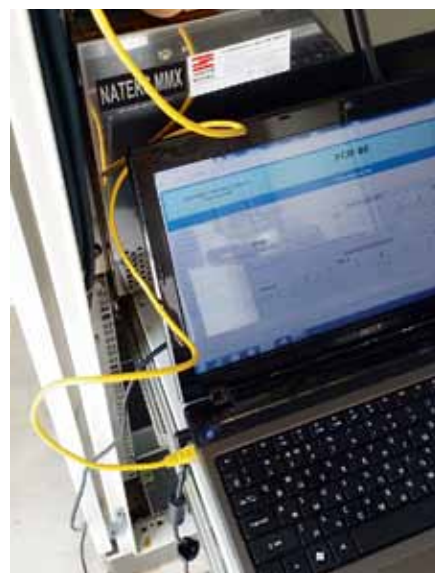
Рис. 3. Мониторинг состояния аккумуляторных батарей дизель-генераторной установки через веб-интерфейс АПК «ЦЕНСОР»
