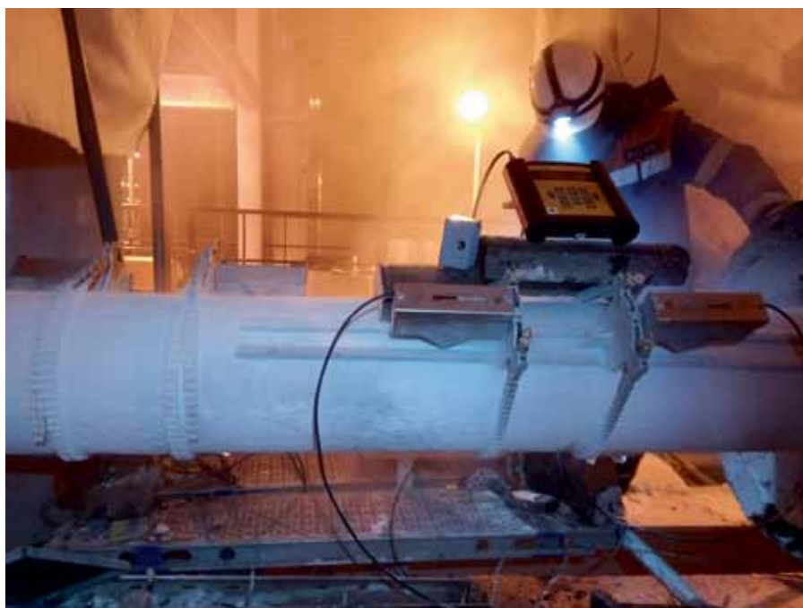
Рис. 3. Монтаж расходомера Flexim FLUXUS F800 на трубе с криогенной жидкой средой
