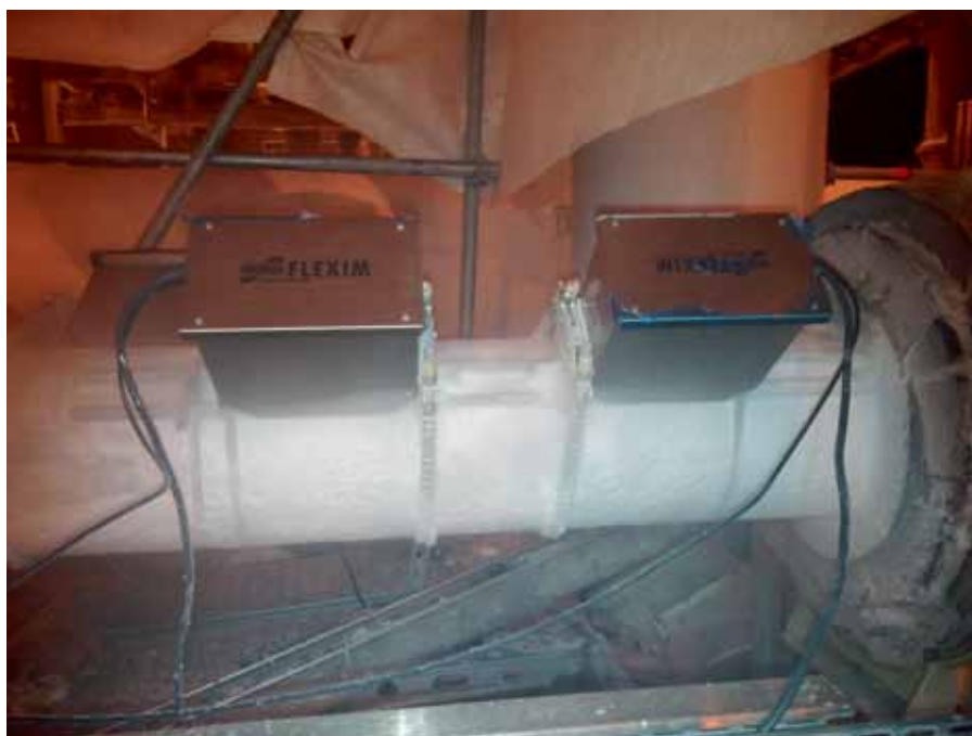
Рис. 2. Расходомер Flexim FLUXUS F800 на трубопроводе с криогенной средой
