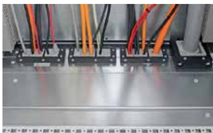
Рис. 15. Ввод кабелей в шкаф с помощью оборудования icotek
